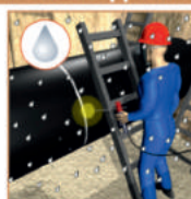
СВАРочНЫЕ РАБОТЫ В ДОЖДЬ БЕЗ ЗАЩИТНОГО ЗАВЕСА
